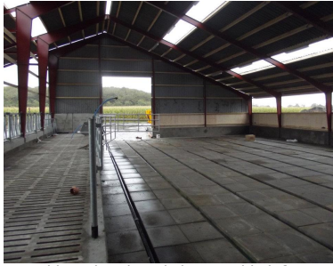
Nyetableret bund med slanger til beluftning. Slangerne er anbragt imellem rækker med to stk. 60x60 cm fliser, som beskytter slangerne mod skader ved fræsning og grubning.
